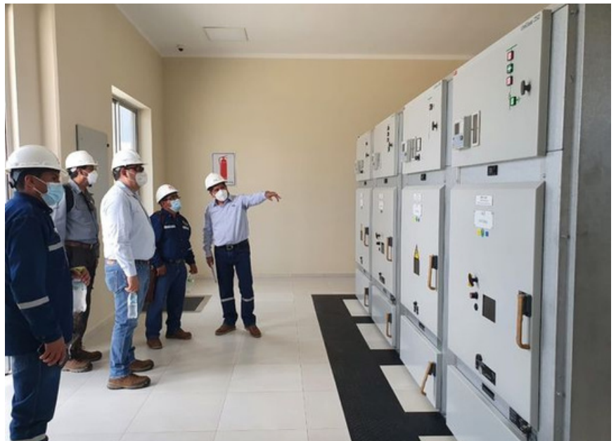
Electrolinera ubicada en la Subestación Norte de ENDE ORURO
